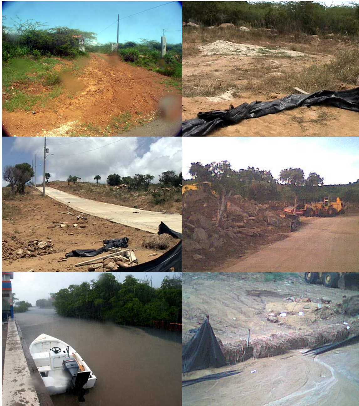
FIGURA 14. Otros ejemplos de las prácticas pobres en el manejo del uso de los terrenos en Culebra: A) muchos caminos privados sin pavimentar están sujetos a tasas de erosión severas; B-D) la mayoría de las actividades privadas y gubernamentales de desarrollo de terrenos carecen de mecanismos efectivos de control de la erosión y sedimentación por escorrentías; E) y F) las escorrentías sedimentadas pueden alcanzar las cuencas naturales y las costas en cuestión de solo algunos minutos.
